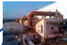
HRSG (Heat Recovery Boiler) Котел-утилизатор
